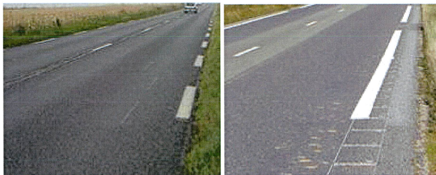
Figure 4. Illustration de la configuration du PT de la RD6014 avant (à gauche) et après (à droite) implantation des BAS de type creusée. Les BAS ont été implantées selon un pas de 80 cm. (Source photo, Le lez/Cerema-DTerNC/2013)
